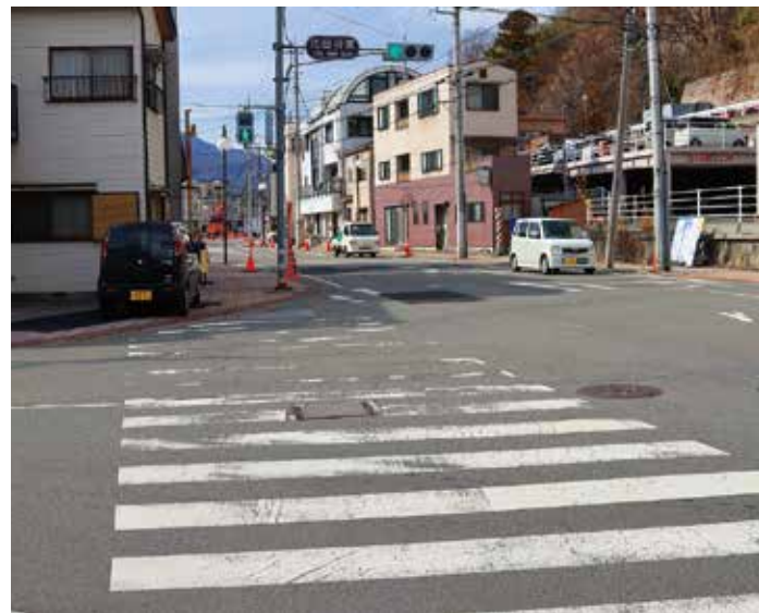
信号機「市役所東」の横断歩道(葦崎市水神)。向こう半分と信号機下の乗用車の前で白の表示が消えかかっている
